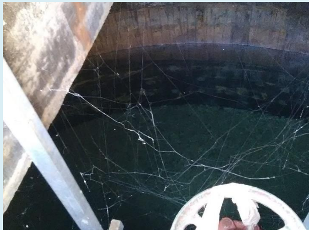
N°3 Vue intérieure du captage de La Mouvière source
